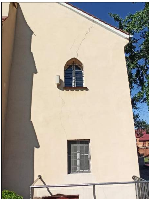
fot. 10. Powstałe spękania w wyniku osiadania budynku – system Helibar
