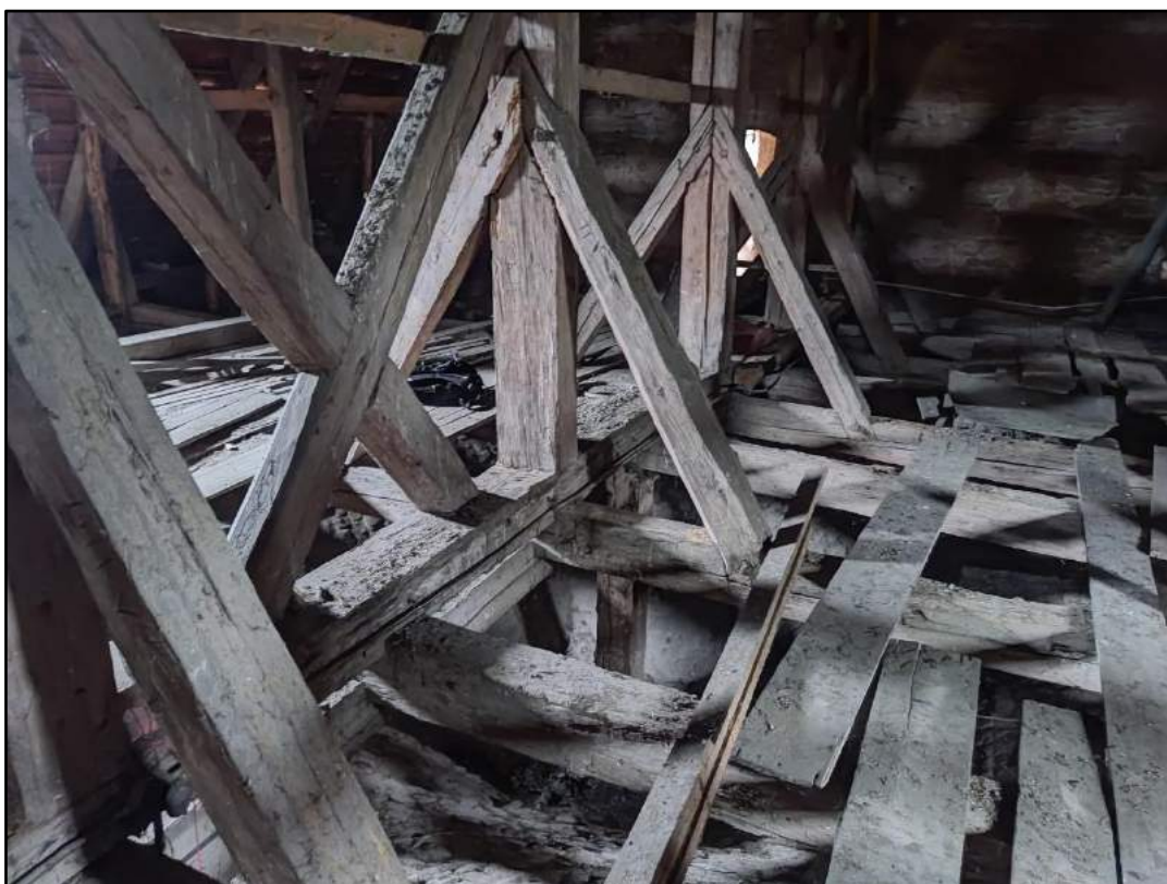
fot. 20. Oczyszczenie i impregnacja zdanych elementów konstrukcyjnych, wymiana desek podłogowych – stworzenie podestu roboczego, wymiana spękanych belek.
