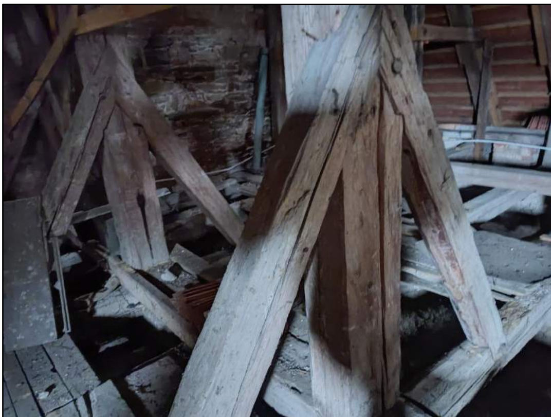
fot. 28. Oczyszczenie i impregnacja zdalnych elementów konstrukcyjnych. Wzmocnienie poprzez dokładkę oraz miejscowa wymiana elementów.
