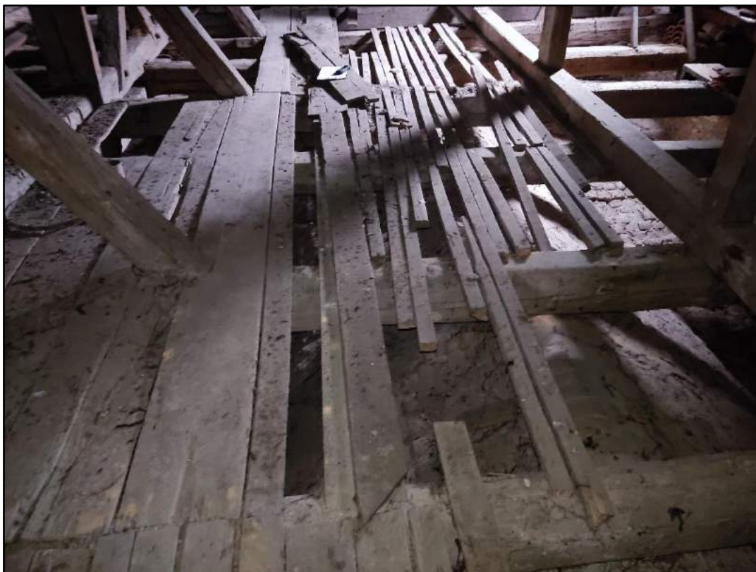
fot. 35. Oczyszczenie i impregnacja zdatnych elementów konstrukcyjnych, wymiana desek podłogowych – stworzenie podestu roboczego, wymiana spękanych belek.
