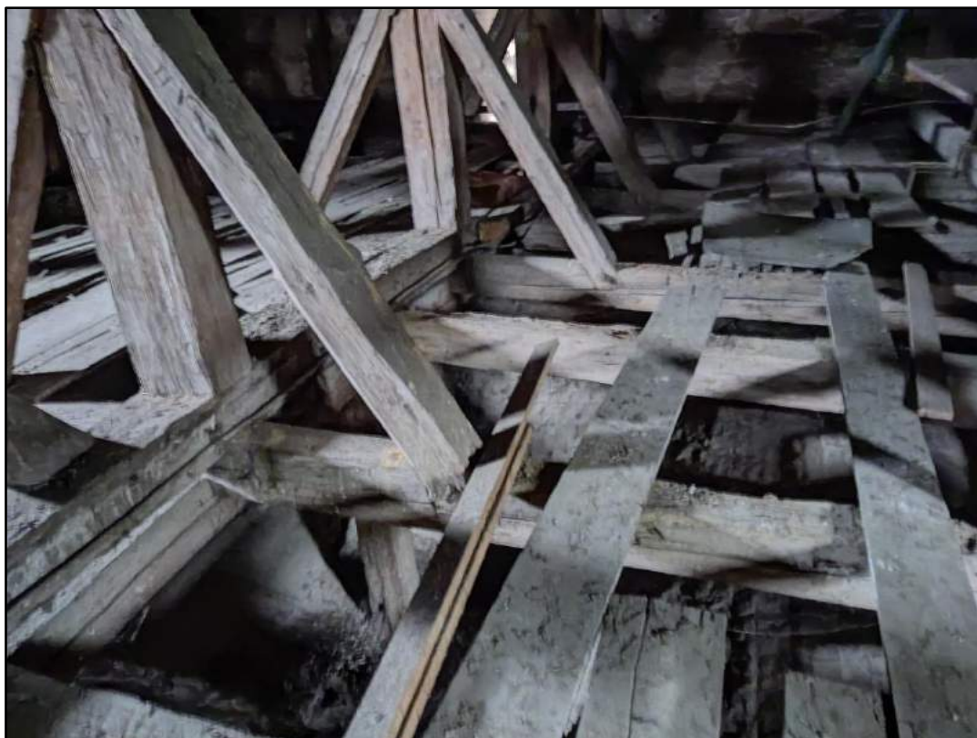
fot. 34. Częściowa wymiana zbutwiałych belek, oczyszczenie oraz impregnacja zdalnych elementów konstrukcyjnych, wymiana desek podłogowych – stworzenie podestu.
